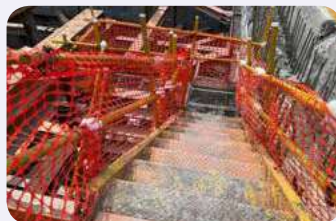
安全樓梯與護欄
