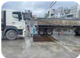
洗車台 - 車輛清洗與沉澱過濾
