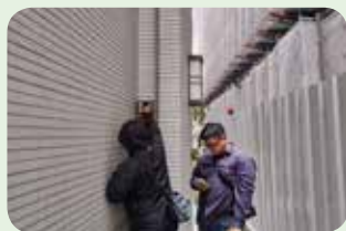
■ 基地周邊鄰房傾斜儀監測
